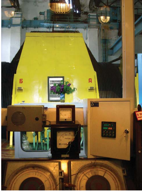
Решения модернизации и технического перевооружения котельных установок успешно эксплуатируются на многих заводах Украины
